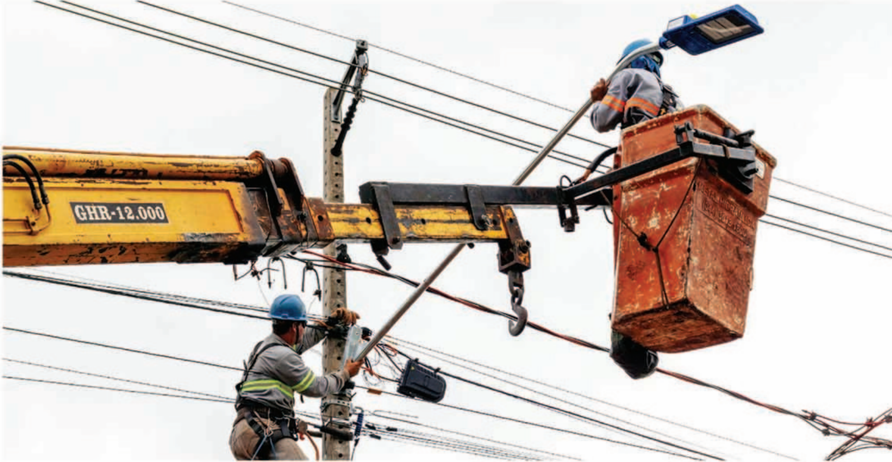
Cambira vai gerar energia para reduzir taxa de iluminação pública Após substituir todas as luminárias por LED, Prefeitura de Cambira anunciou nesta sexta-feira projeto de instalação de duas usinas fotovoltaicas. Geração de energia vai garantir redução de custos no sistema de iluminação. PÁG. A8
